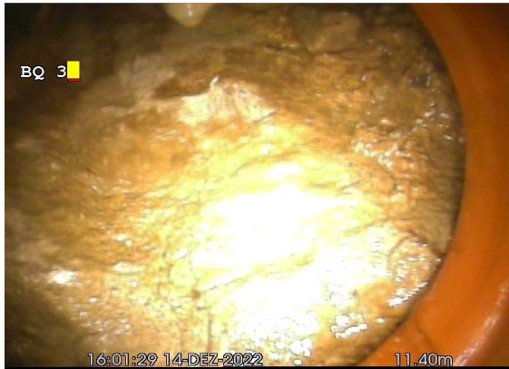
Ende der Quellwasserfassung, Leitung mit Stein verschlossen
