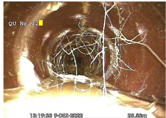
Wurzeinwüchse durch Schadstellen in Rohren oder Sickerrohren
