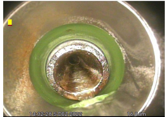
Leitungsübergänge können Schwachstellen und undicht sein
