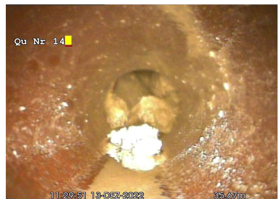
Defekte und durch Steine verstopfte Leitungen
