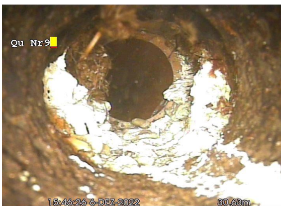
Verminderter Leitungsquerschnitt durch Kalkablagerungen
