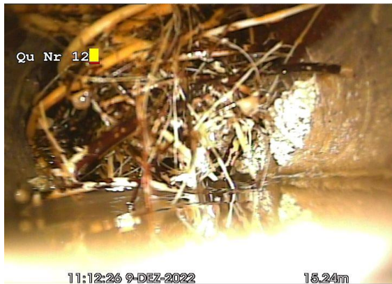
Wurzeinwüchse durch Schadstellen in Rohren oder Sickerrohren
