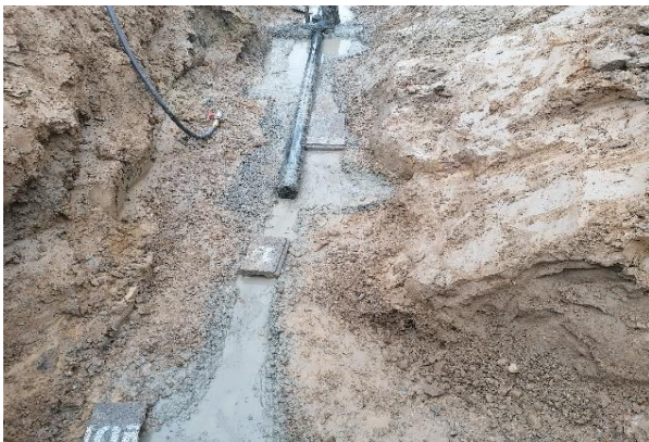
Mehrere Wassereintritte in Quellrohr fassen
