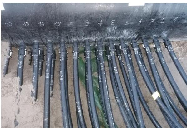
Anschluss an erdverlegten Verteilschacht
