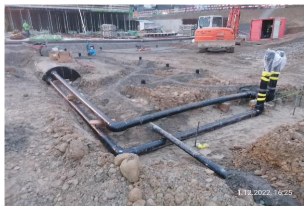
Sammelleitung vom Schacht bis in den Technikraum
