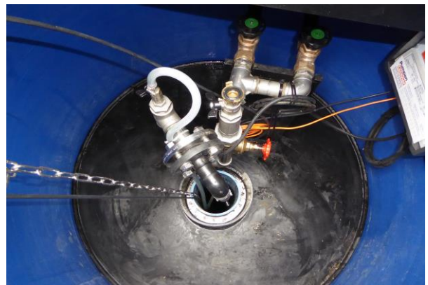
Installation im Kopfschacht mit Pumpensteuerung
