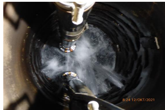
Einströmendes Grundwasser nach mehrmaligen Reinigungsdurchgängen
