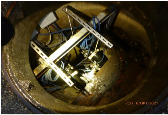
Blick in den Bohrbrunnen mit Installationen von zwei Förderpumpen
