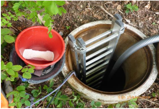
Einstieg in ein Reservoir mit Betondeckel Ø600mm. Der Deckel ist undicht.
