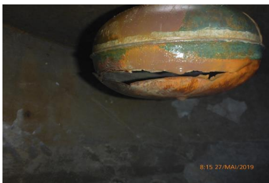
Defekte Schwimmerblase bei einem Einlaufventil.
