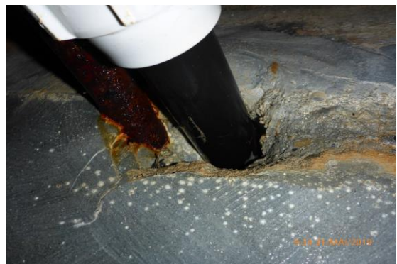
Undichte Ein- und Ausläufe. Über diese Stellen kann Schmutzwasser in die Schächte gelangen.
