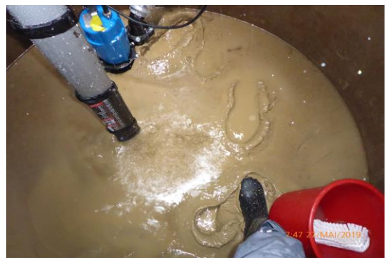
Reservoire ohne Bodenablauf. Schmutz kann nur mit Spezialpumpen entfernt werden.
