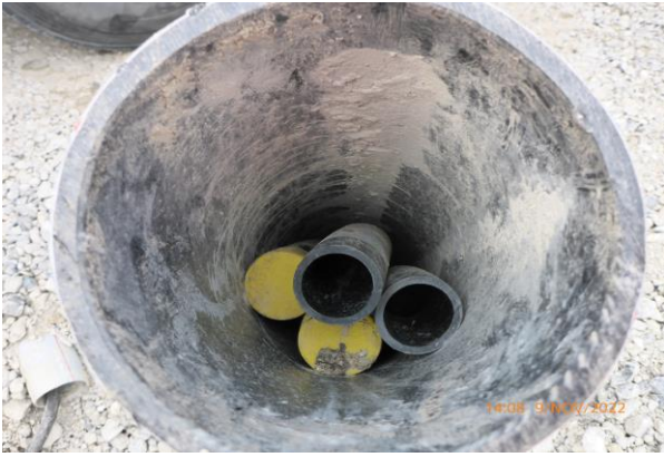
Ausgangslage: Erdsonden mit Schutzrohr und zum Teil ohne Verschlusskappen
