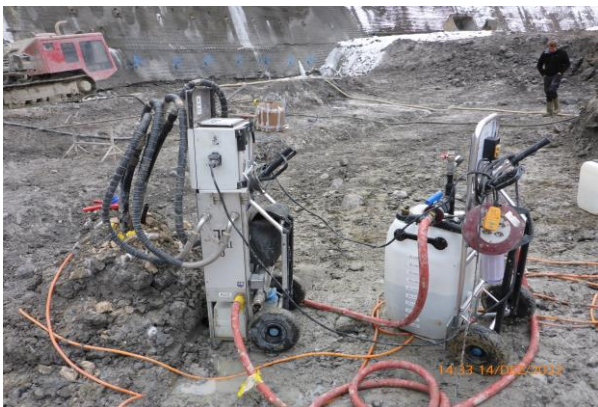
Prüfgerät Durchfluss- und Druckprüfung nach SIA 384-6
